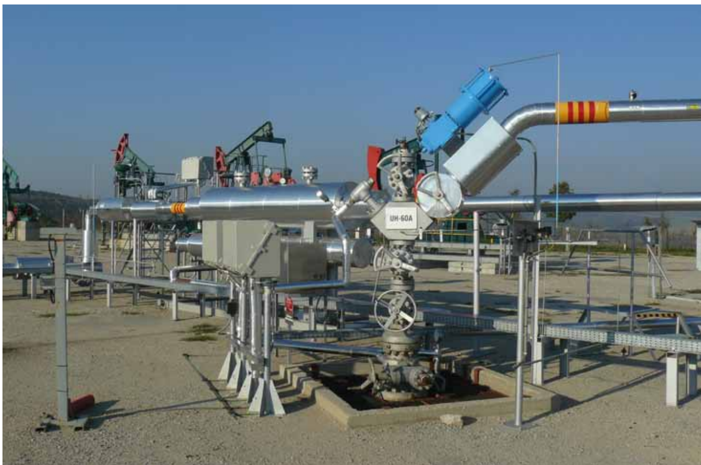
Charakteristické vystrojení ústí vrtu (produkční kříž tvaru písmene Y)
