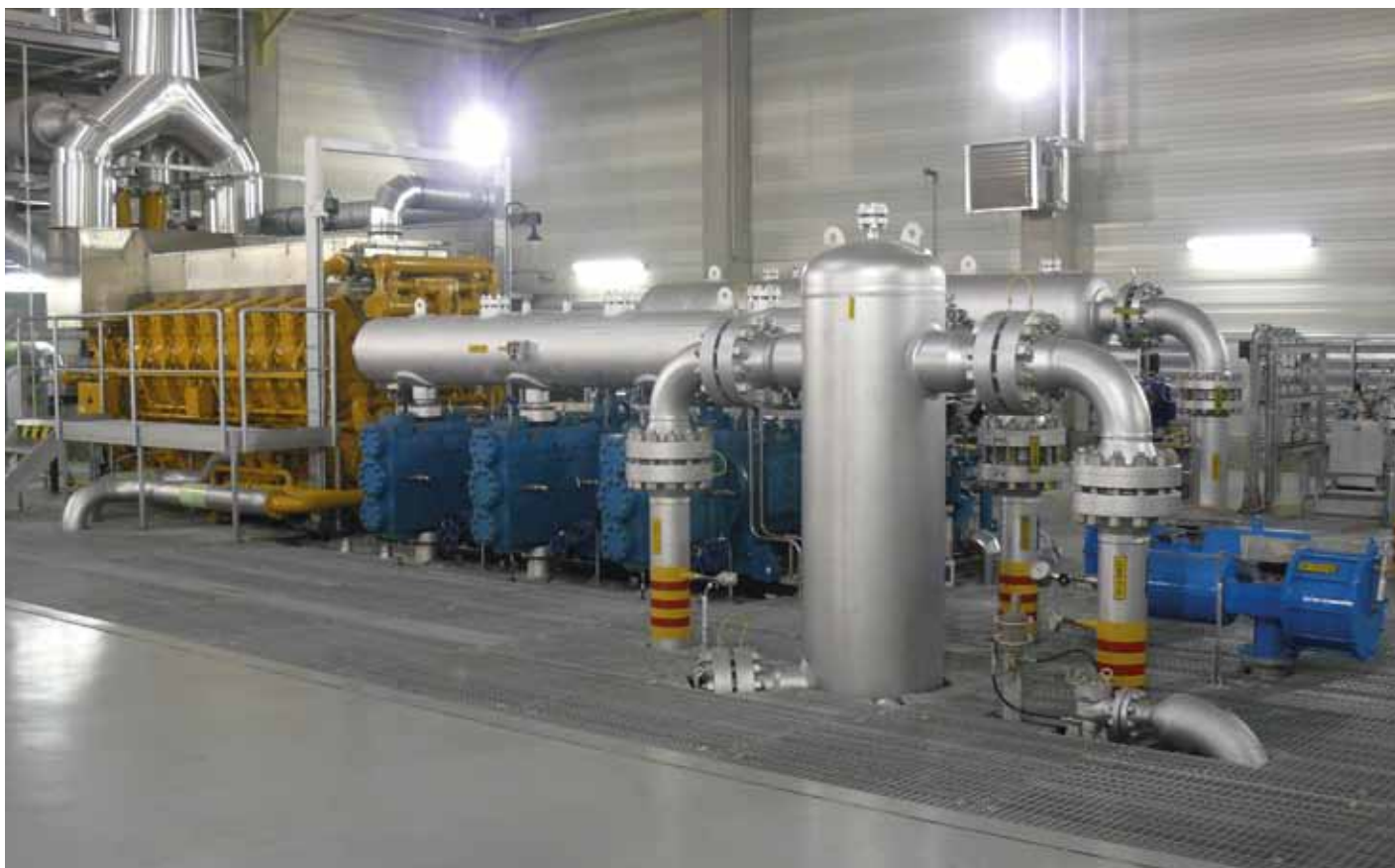
Kompresorová jednotka PZP Uhřetice Jih. Žlutá část je plynový motor Catterpillar, modrá část je kompresor Ariel
