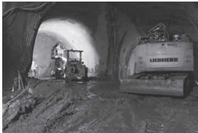
Obrázek č.1: Rozrážka vzduchotechnické štoly z přístupové štoly, na čelbě injektáž svorníků
