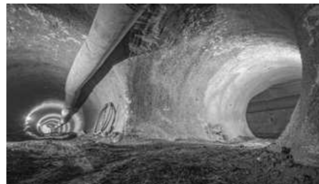
Obrázek č. 12: Vzduchotechnická propojka
