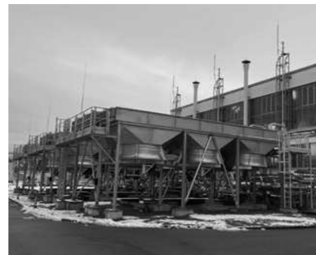
Chladiče kompresoru na PZP Tvrdonice
