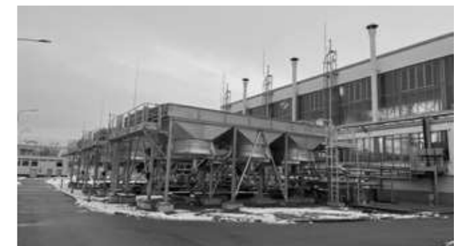
Chladiče kompresorů na PZP Tvrdonice
