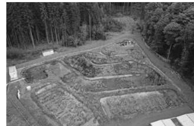
Pasivní remediační systém čištění vytékajících vod z lomu Hájek
