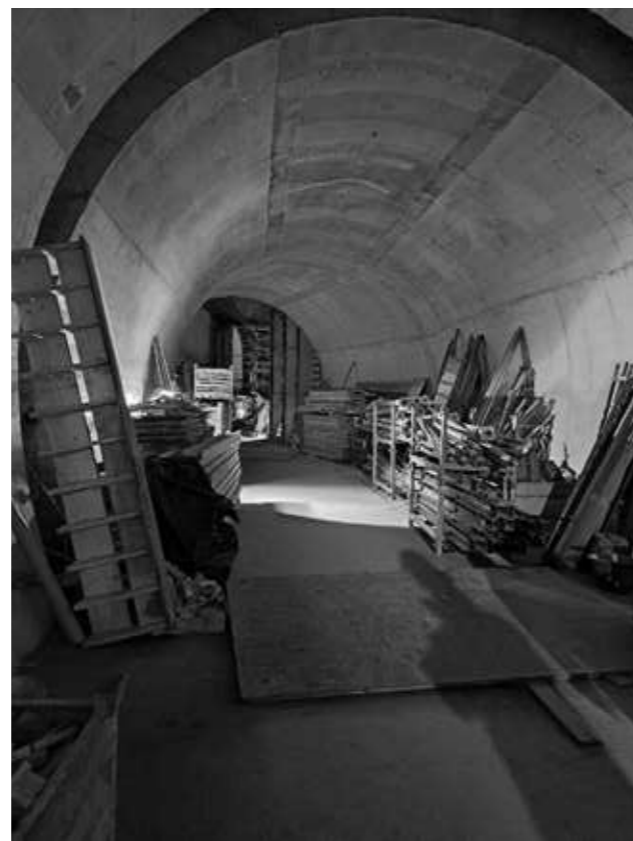
Obrázek č. 27 - Pohled na def. ostění chodby UPCH od šachty Š1
