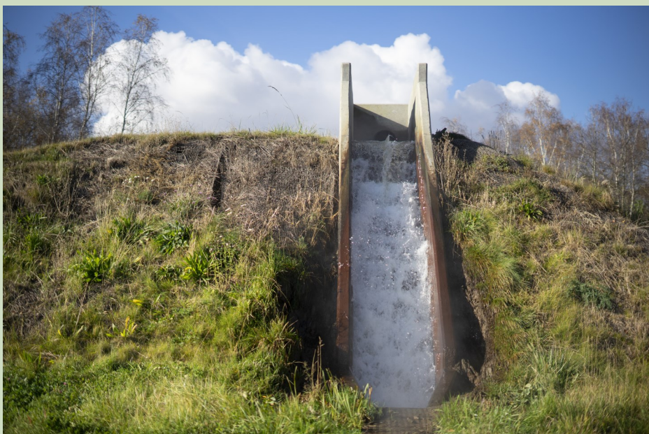
Obr. č 2: Provzdušňovací (přívodní) objekt
