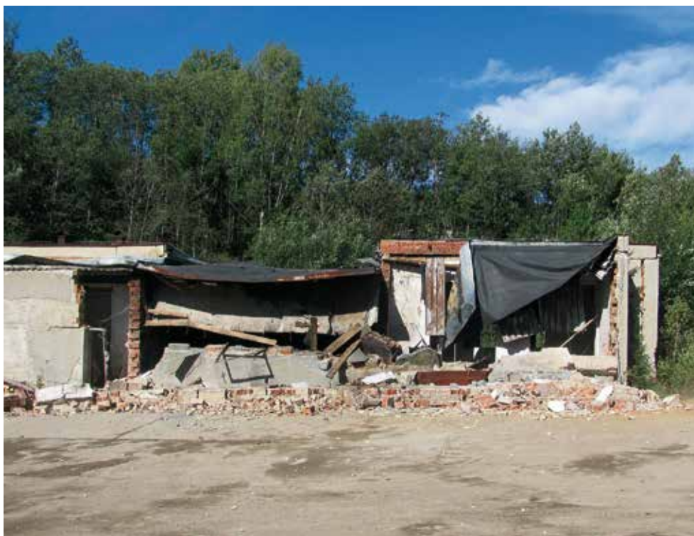
Obr. č. 5: Destrukce přední nosné stěny po zk. 3
