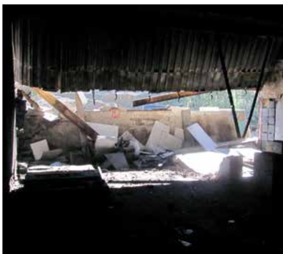
Obr. č. 6: Vnitřní pohled destrukce přední stěny
