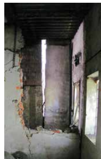
Obr. č. 7: Posunutí protilehlé stěny
